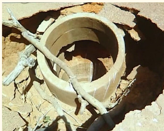
Point d'eau en mauvais état
